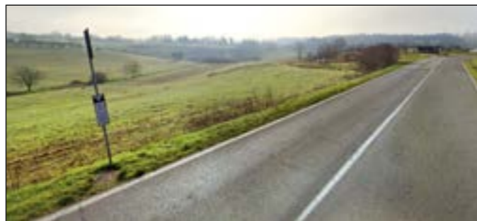
Priva di banchina (precedente all'intervento)
